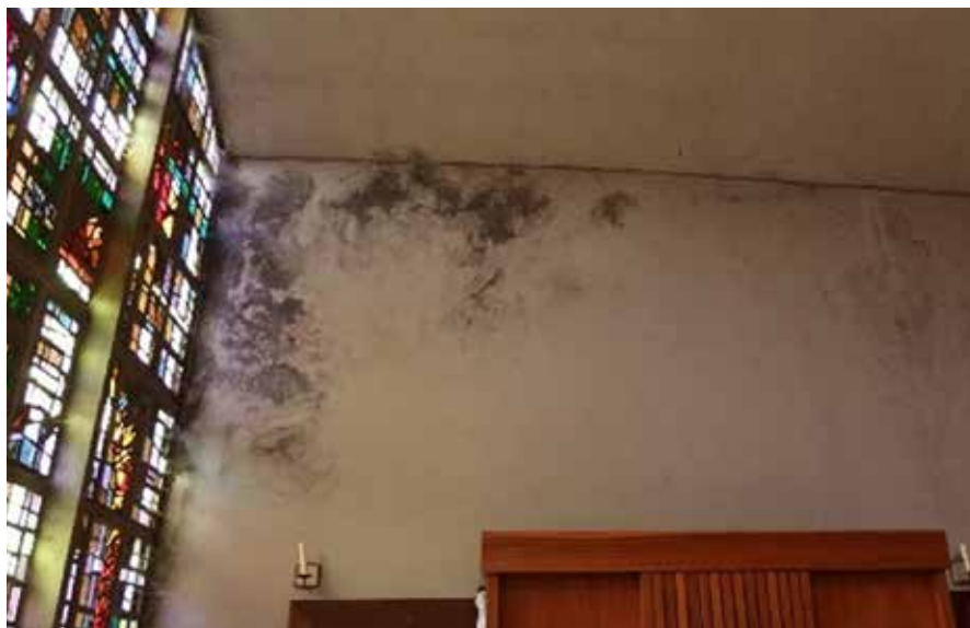
Le mauvais état des gouttières et de la couverture du bas-côté ont fait apparaître des traces d'infiltration d'eau avec des auréoles noires, mêlées de développements biologiques et de cristallisations de sels.
