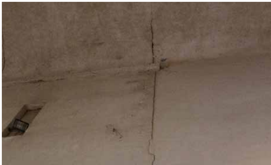
Plusieurs nombreuses fissures transversales affectent la voûte de la nef, dont certaines sont très ouvertes et provoquent de l'oxydation sur le nergalto et les suspentes.
