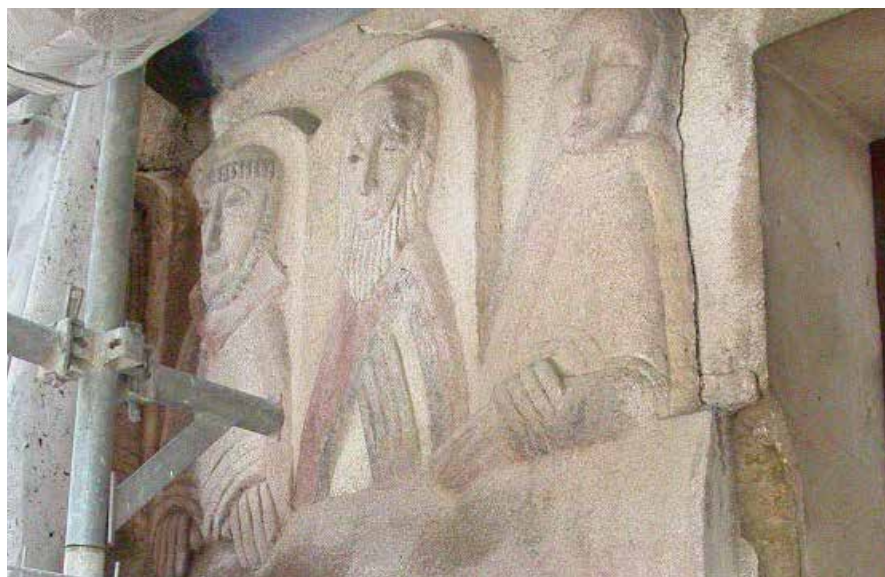
Les bas-reliefs de la façade occidentale (ici représentant la Cène) ont subi des infiltrations, qui altèrent la polychromie et risquent de détacher les éléments sculptés.
