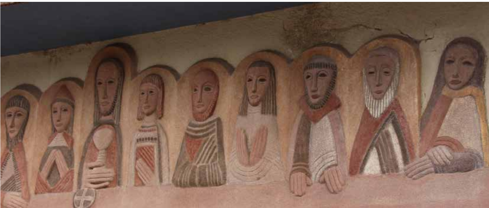
Les bas-reliefs de Jean-Lambert Rucki, sur la façade occidentale, sont inscrits au titre des Monuments historiques. Ils nécessitent des travaux de protection.
