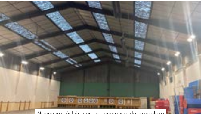
Nouveaux éclairages au gymnase du complexe sportif Michel Castaing.
